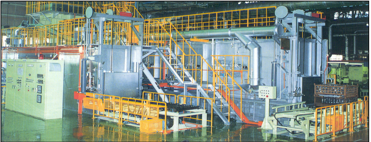
Instalación Tratamiento Térmico T6 provista de mesas de carga y descarga.
