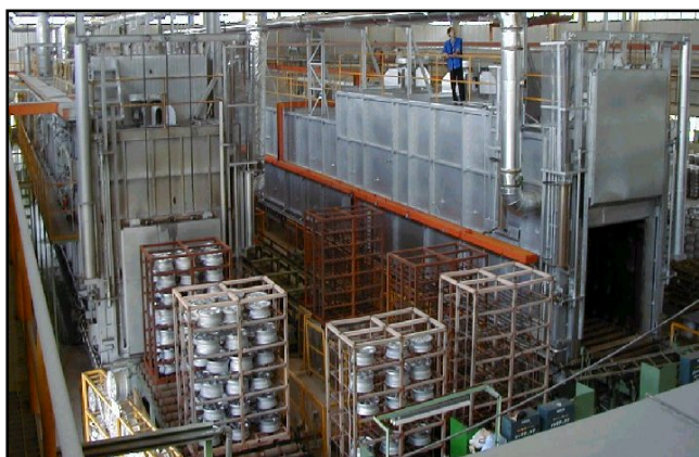
Vista general Instalación Tratamiento Térmico T6 en disposición tipo "U".
