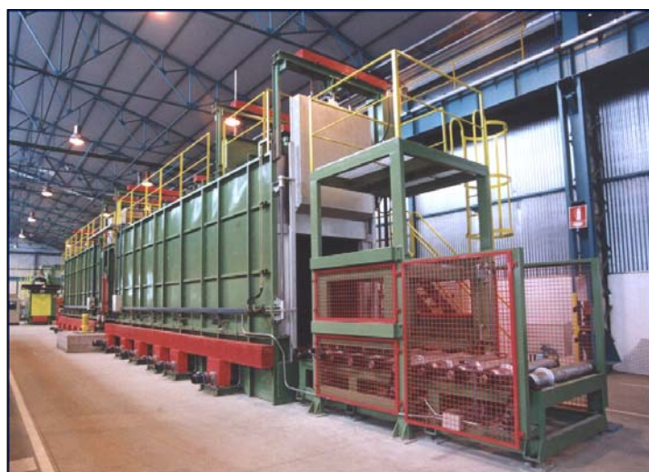
Vista general Instalación Tratamiento Térmico T6 en disposición lineal.
