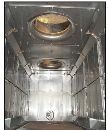
Vista interior cámara Horno.
