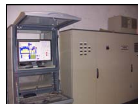
Armario Eléctrico con sistema informático.
