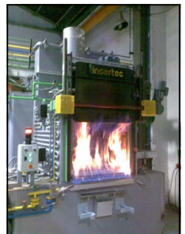
Vista puerta descarga Horno.
