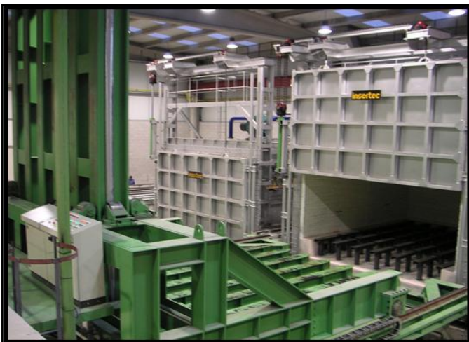
Vista general Instalación de Tratamiento Térmico.
