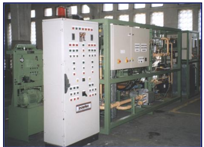
Generador de atmósfera y panel de control de la instalación.
