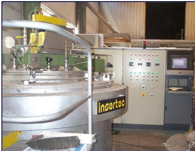
Horno de pote, con detalle del sistema de control.
