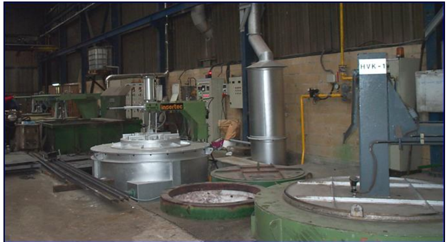
Instalación de hornos de pote para Recocidos de picerio diverso en acero.
