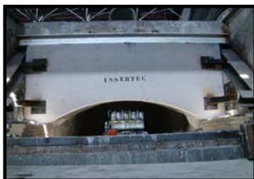
Dintel del Horno
