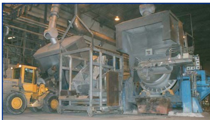
Vista geral da Instalação com 2 Fornos Mini-FARB-4
