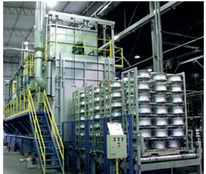
\ Cestas preparadas sobre mesa de carga.
