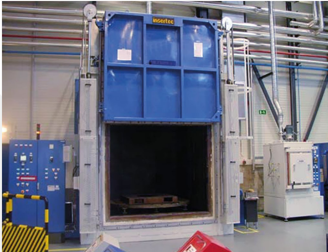
\ Distintos hornos de recirculación tipo cámara.
