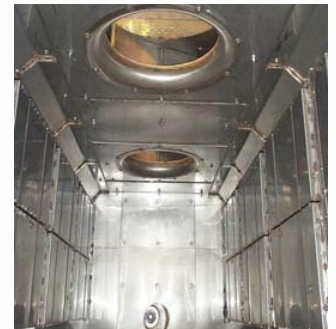
\ Vista interior cámara horno.
